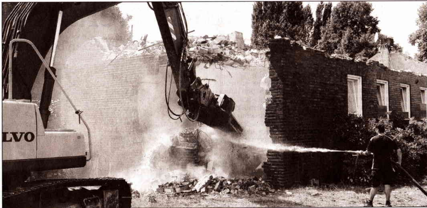
Jede Menge Staub wirbelte auf, als Bagger und Betonschere gestern das Schicksal des ehemaligen Pfarrhauses der Ludgerusgemeinde besiegelten. Von 1965 bis 1990 wohnte Pfarrer Günter Heen dort, von 1990 bis 2008 sein Nachfolger Ulrich Theißen. Seit 2008 stand das Gebäude leer. —FOTO: KLEINE
